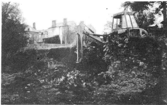
Terrassements préparatoires du chantier 1987 de l'A.R.C.D. au château de Domfront (novembre 1986) - Photo A.R.C.D.
